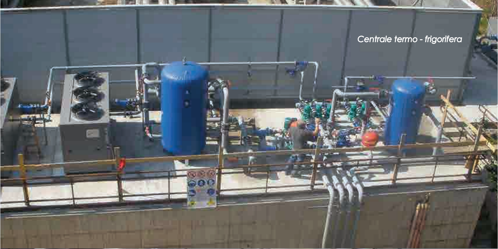
Centrale termo-frigorifera con rivestimento in lamierino
